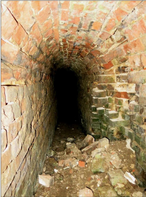
Abbildung 17: Außengang Bastion "Held" mit kleineren Mauerwerksschäden im Eingangsbereich.
